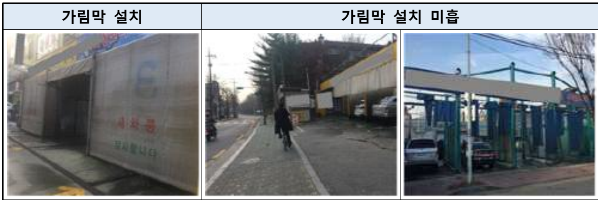
[ 칸막이 가림막 (미)설치 사례 ]
