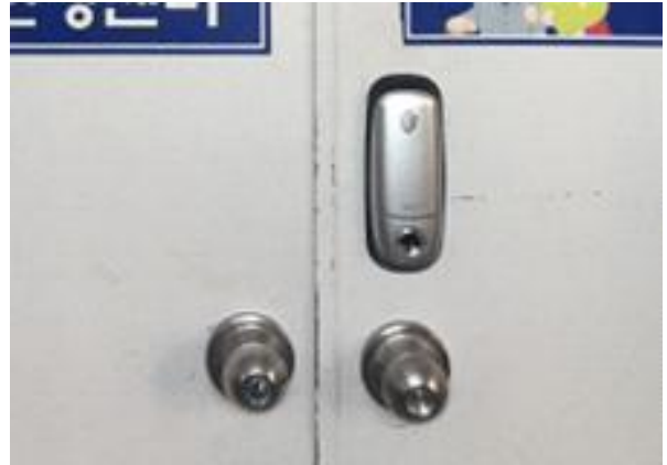
[단순 번호키 설치]
